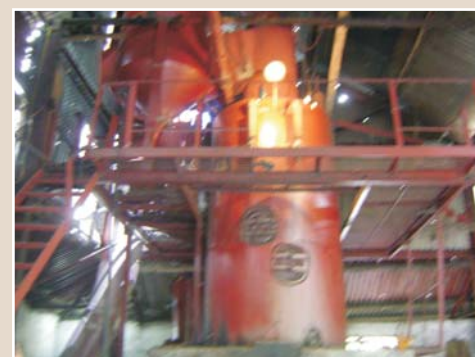
Hệ thống xử lý khói bụi lò hơi nấu cồn.
