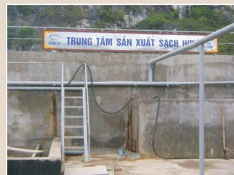
Hệ thống xử lý nước hèm thải
