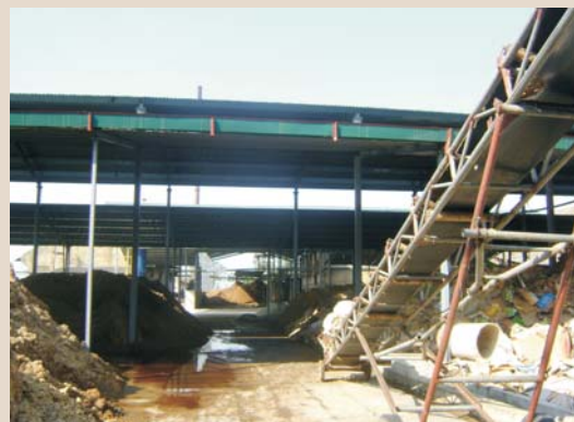
Hệ thống mái che nguyên liệu đầu và bột sau nấu
