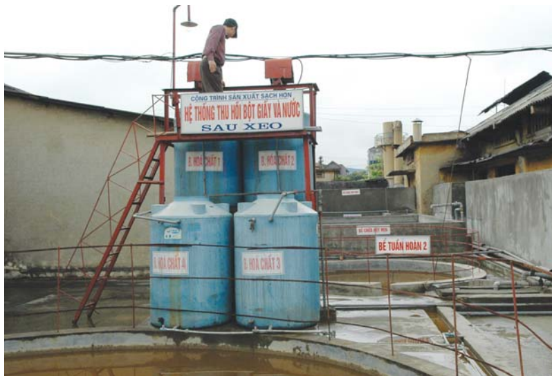
Công trình SXSH - hệ thống thu hồi bột giấy và nước sau xeo tại Công ty CP Giấy Xuất khẩu Thái Nguyên.
