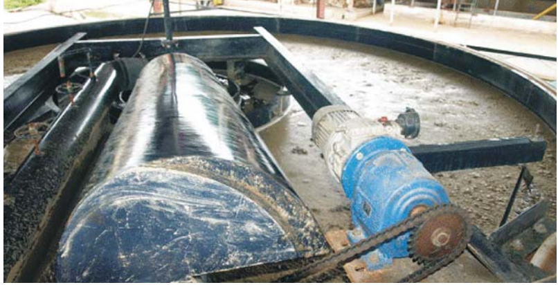
Hệ thống tuyển nổi thu hồi bột giấy trong nước thải xeo tại Công ty Cổ phần Giấy Sông Lam - đơn vị tham gia dự án của CPI.
