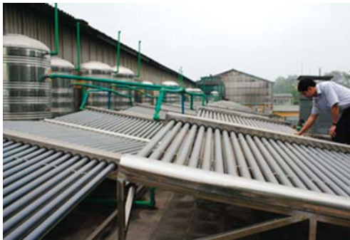
Hệ thống gia nhiệt NLMT Công ty Sông Hồng.
