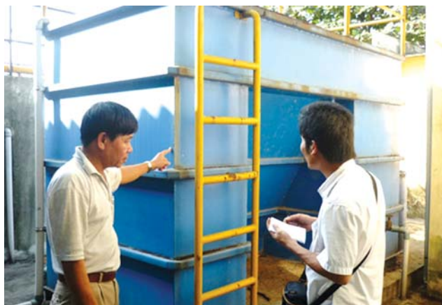
Hệ thống sục khí tại Xí nghiệp dầu máy Đà Nẵng.
