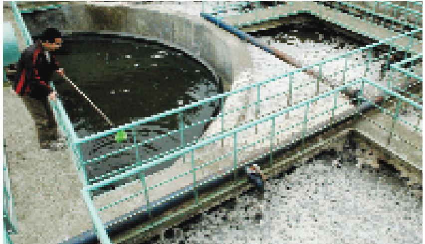
Việc xây dựng hệ thống xử lý nước thải giúp Công ty giảm ô nhiễm hiệu quả.
