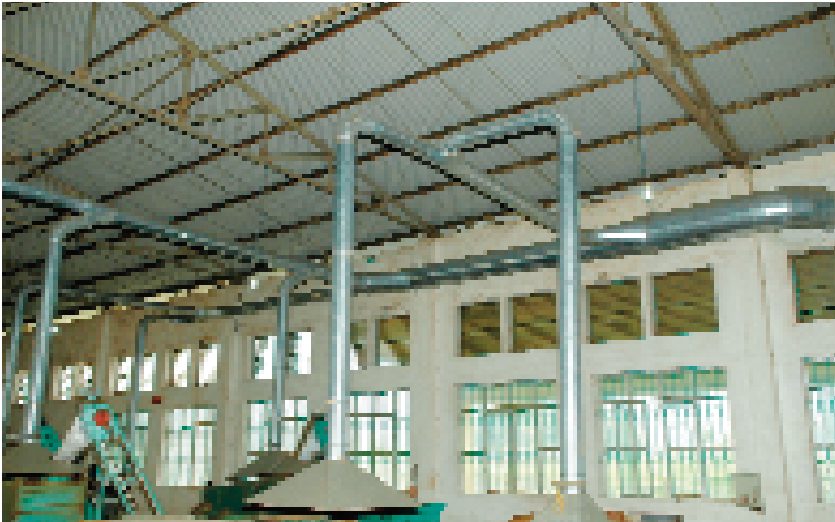
Lắp đặt hệ thống thu bụi chè tiết kiệm nguyên liệu.
